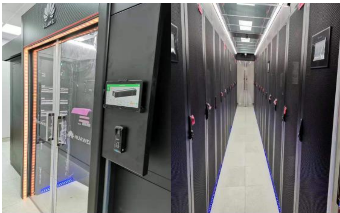
图 5 学校中心机房
